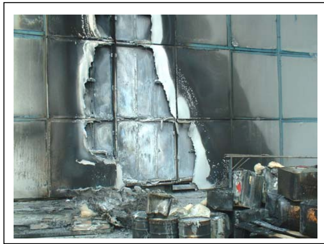
照片 5.19 火災事故---裙樓南側屋頂露台 PU 防水材起火。
