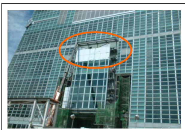
照片 5.25 塔樓入口鉤掛式鋁板及泛水尺寸錯誤。
