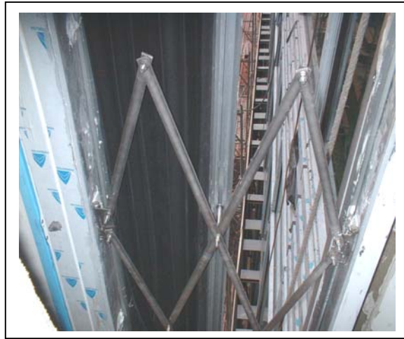
照片 5.16 伸縮縫垂直蓋板施工缺失
