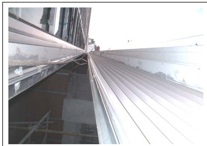
照片 5.15 伸縮縫垂直蓋板施工缺失
