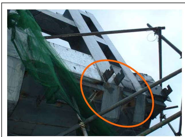
照片 5.12 轉角單元二次鐵件之預埋件遺漏補作(左)
