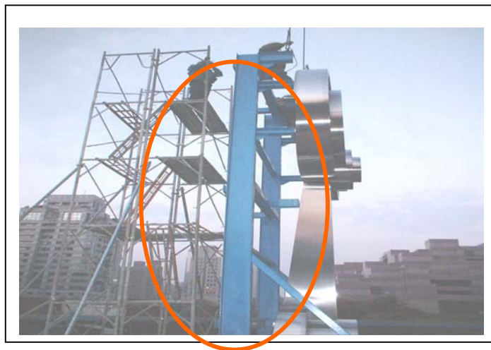
照片 5.17 不鏽鋼造型飾物施工架安全措施不當
