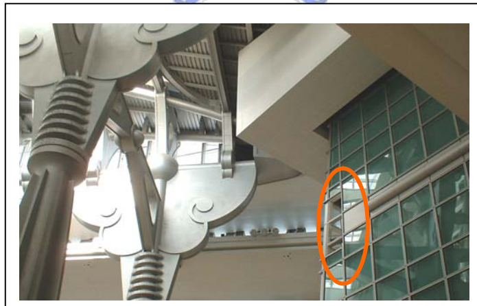
照片5.9 現場施工管理缺失
