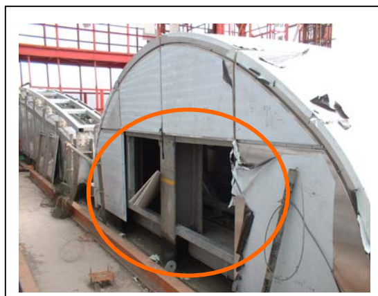
照片 5.26 塔樓中央不鏽鋼造型飾物之背板尺寸不符。
