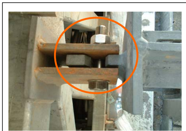
照片 5.7 不鏽鋼造型安裝缺失
