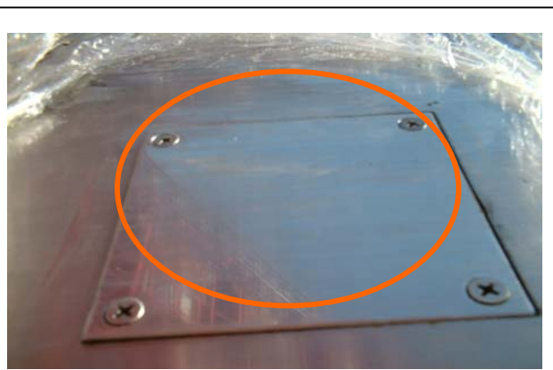
照片 5.8 不鏽鋼造型安裝缺失
