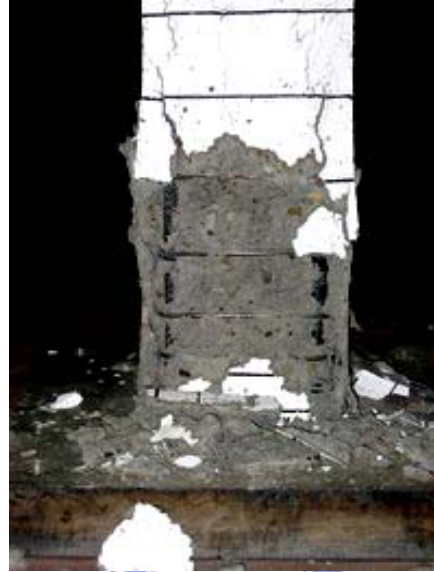
(b) 混凝土保護層剝落： 位移達 1.70\Delta_{pu} 時
