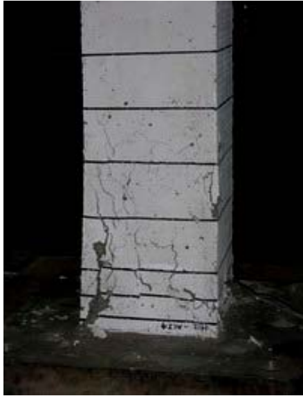
(a) 混凝土保護層開裂： 位移達 1.30\Delta_{pu} 時
