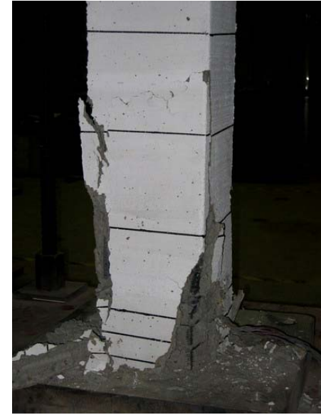
(c) 混凝土明顯開裂： 位移達 1.93\Delta_{p_0} 時
