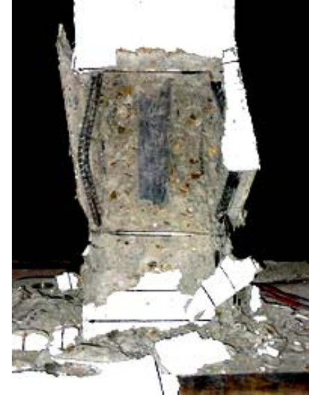
(c) 混凝土嚴重剝落： 位移達 2.04\Delta_{pu} 時
