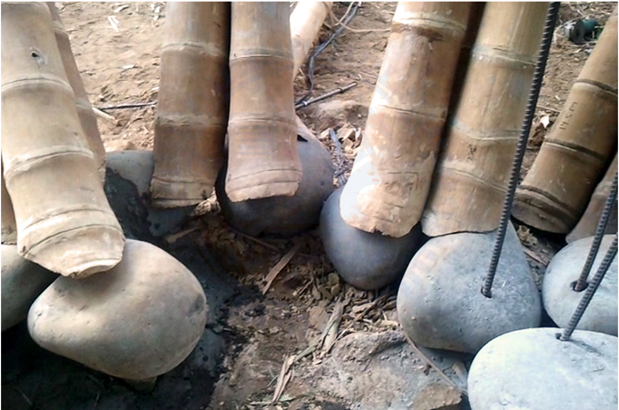
柱與地面接點處理使用河石作基底，中間穿入鋼筋，後從竹桿上挖洞灌入水泥固定。
