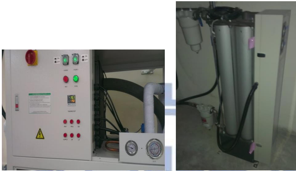
圖 3-5 冷凍機及乾燥空氣機
