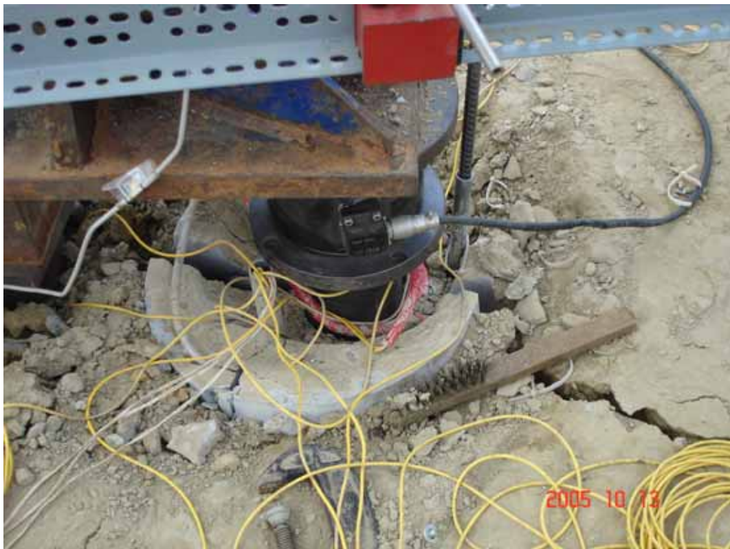
圖 5-1 現地樁載重樁體破壞之實體圖
