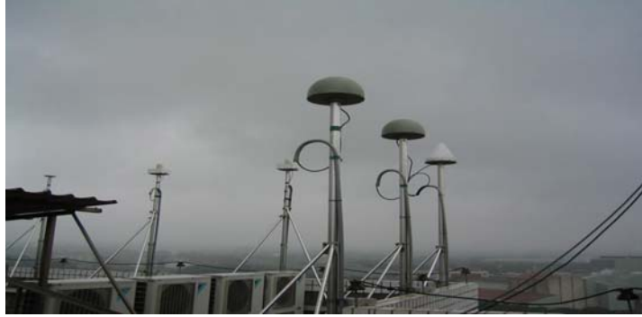
圖4-11 TWTF站所使用的天線盤
