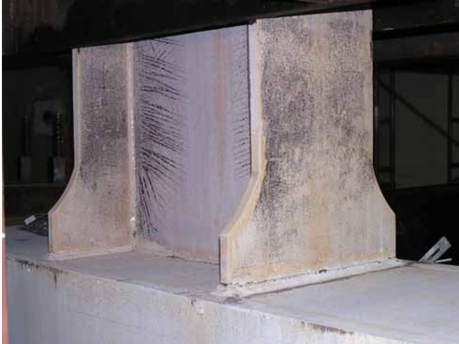
照片 4.14 試體 W08-L1 梁翼板大範圍石灰剝落 (3% drift)
