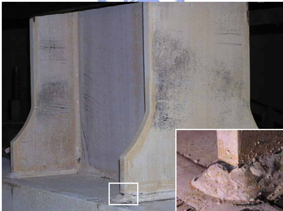
照片 4.12 試體 W08-L1 梁腹兩側呈現斜向斑紋，梁翼全滲透銲道上 兩側有些微的石灰剝落 (1.5% drift)
