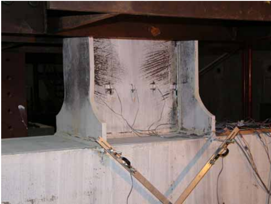
照片 4.7 試體 W10-L1 於梁上翼板與下翼板皆發生輕微的局部挫屈 (3% drift)
