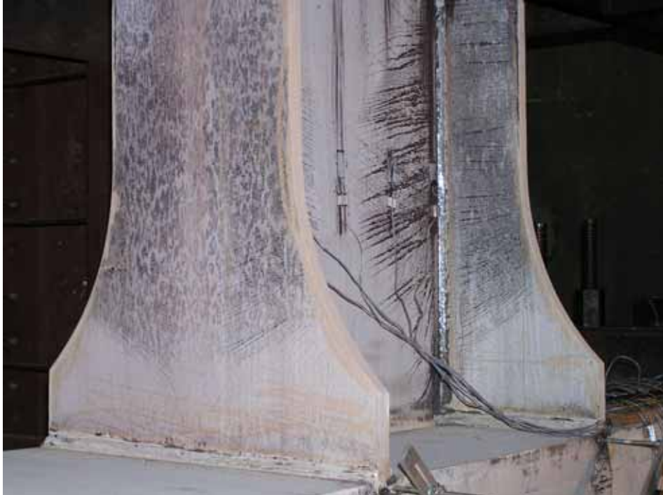
照片 4.22 試體 W10-L2 於梁翼板大範圍石灰脫落 (3% drift)
