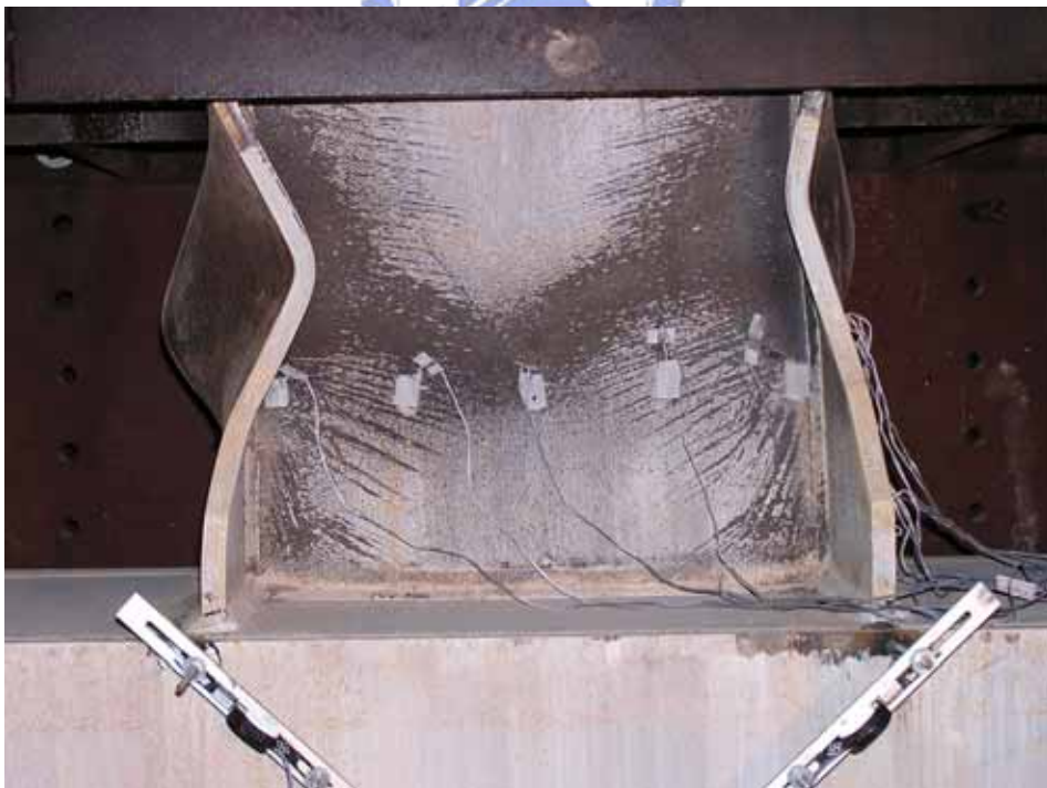
照片 4.16 試體 W08-L1 梁翼板嚴重挫屈 (5% drift)
