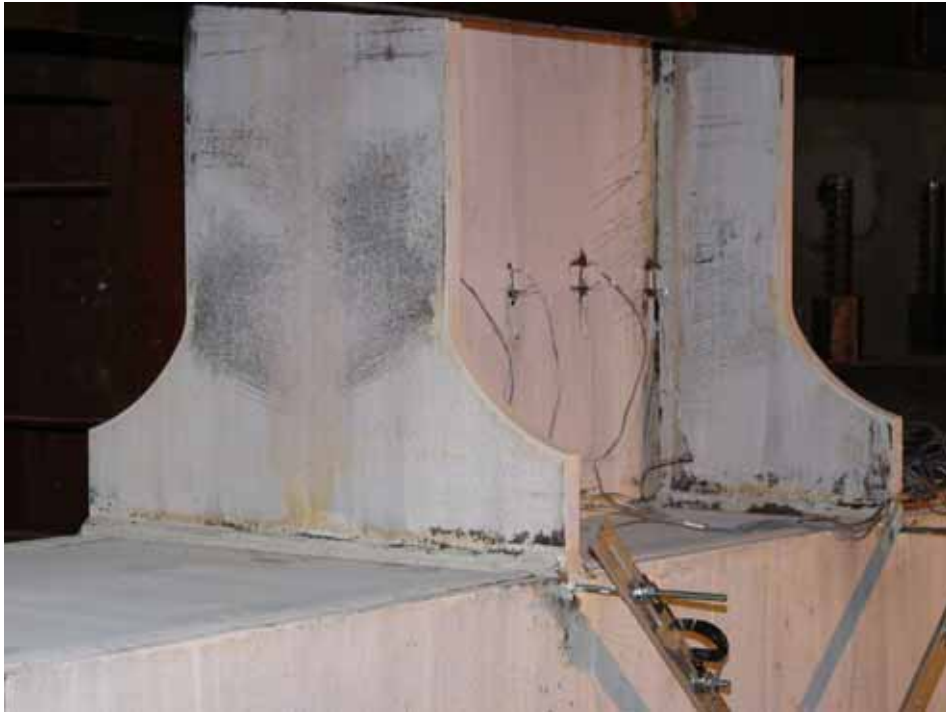
照片 4.5 試體 W10-L1 於下擴翼板圓弧段末端處呈現放射狀石灰剝落，梁腹兩側發現斜向斑紋 (1.5% drift)
