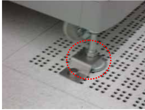
圖 1.4 機台腳柱彎曲破壞
