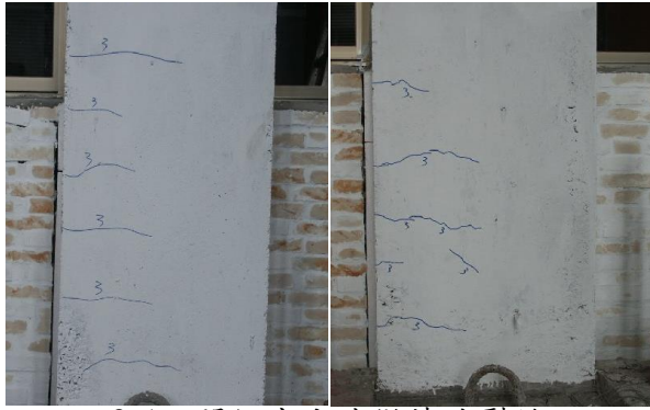
0.5% 開始產生些微撓曲裂縫
