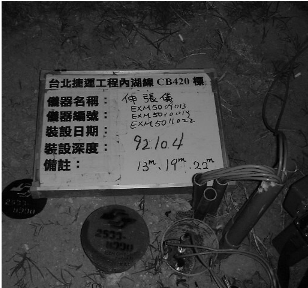
圖 4-24 主跑道南側草坪之多點式桿式伸縮儀 (EXM) (摘自捷儀工程顧問公司 2003)
