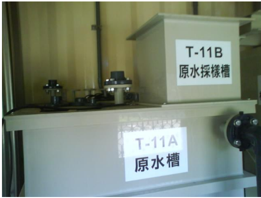
原水槽及原水採樣槽
