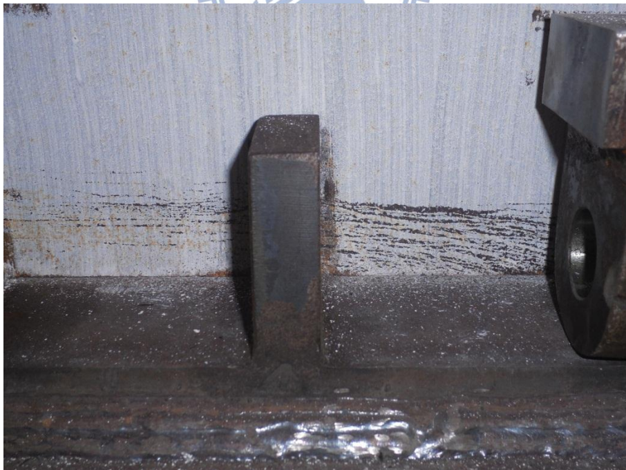
圖 4.28 鋼柱與基礎接面石膏漆剝落
