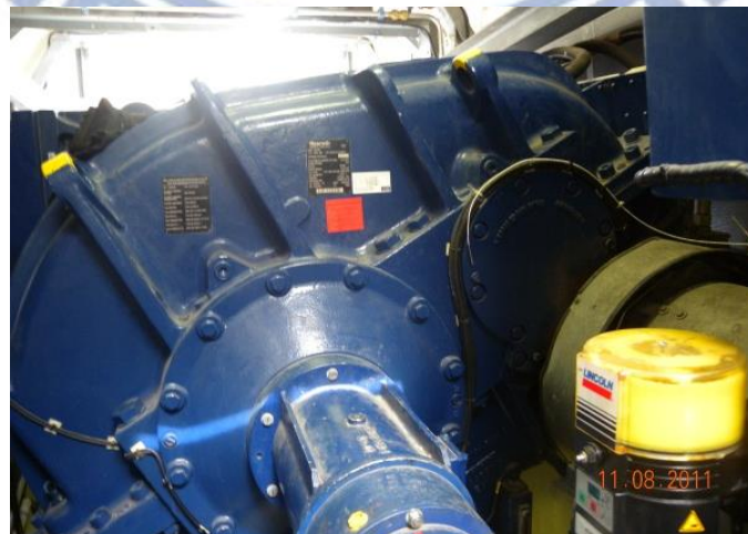
圖 6 軸輪式風力機內部的輪軸箱部分
