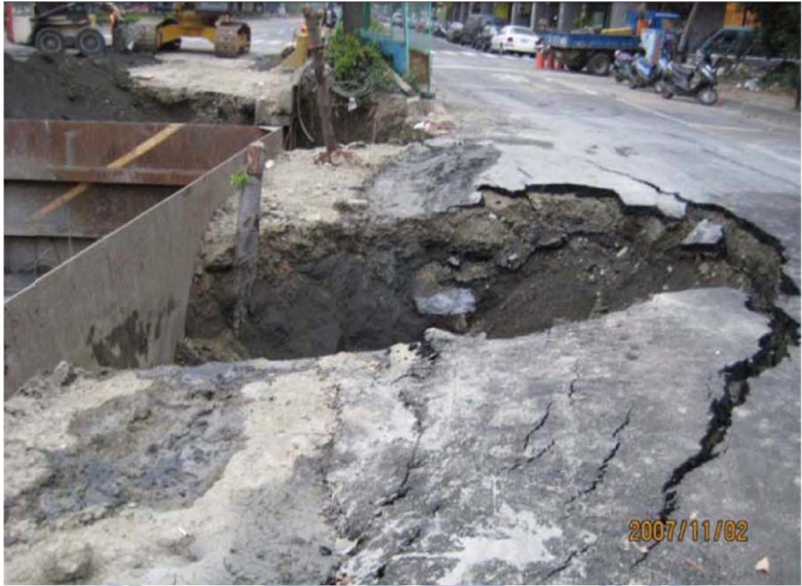
圖 3-13 三號沉箱施工導致鄰近地盤沉陷及路面掏空 (摘自蔡惠文, 2011)
