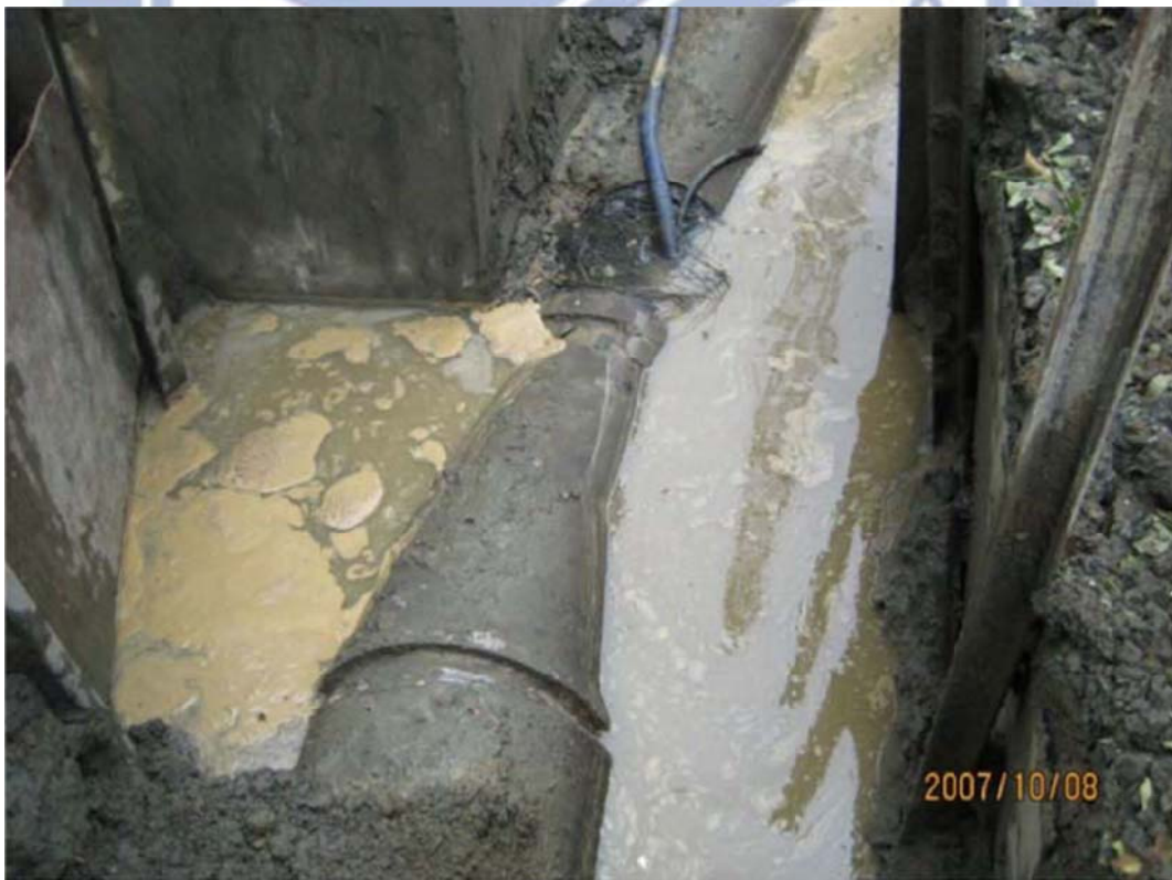
圖 3-12 三號沉箱施工導致放流管挫曲 (摘自蔡惠文, 2011)
