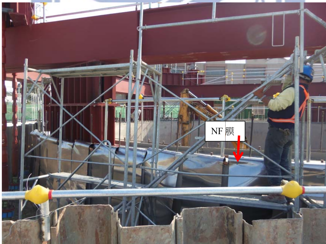
圖 4-18 掛於第一層沉箱上的 NF 膜
