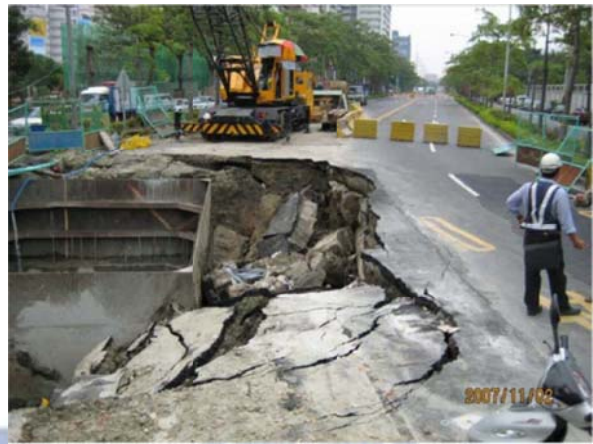
(b) 壓重式沉箱開挖導致鄰近之地層掏空
