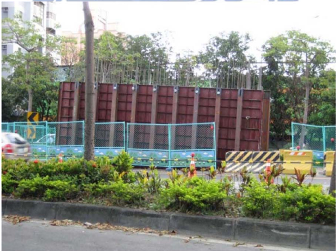
圖 3-23 二號沉箱的不均勻沉陷 (摘自蔡惠文，2011)
