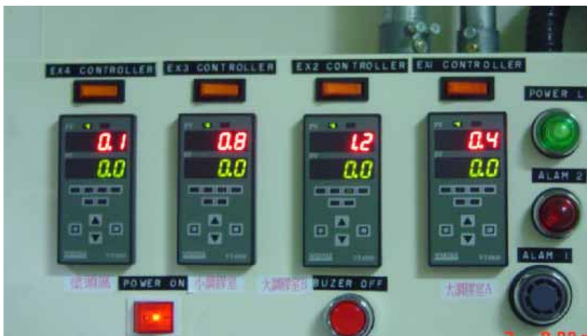
圖 4-15 有機溶劑濃度偵測器控制箱
