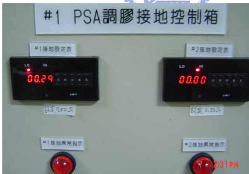
圖 4-17 AIR 接頭接地啟動泵浦控制箱
