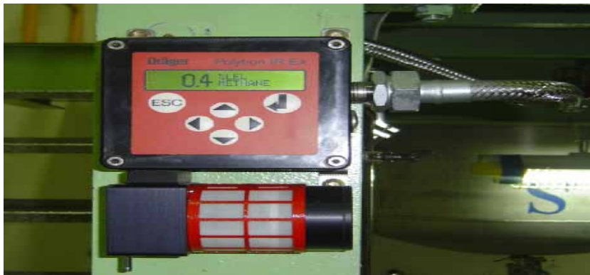
圖 4-14 現場之有機溶劑濃度偵測器
