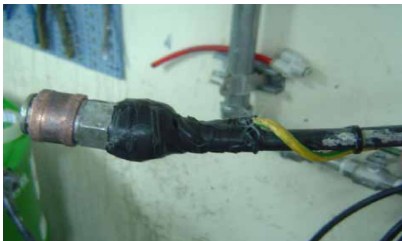
圖 4-16 AIR 接頭接地啟動泵浦偵測器
