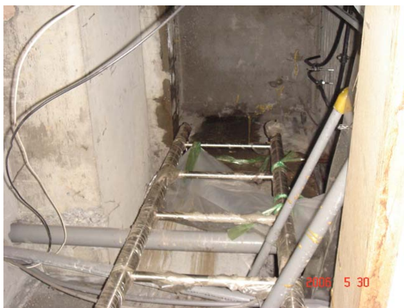
圖 3.2-6 地下層逃生梯至地面層開口封閉，影響逃生
