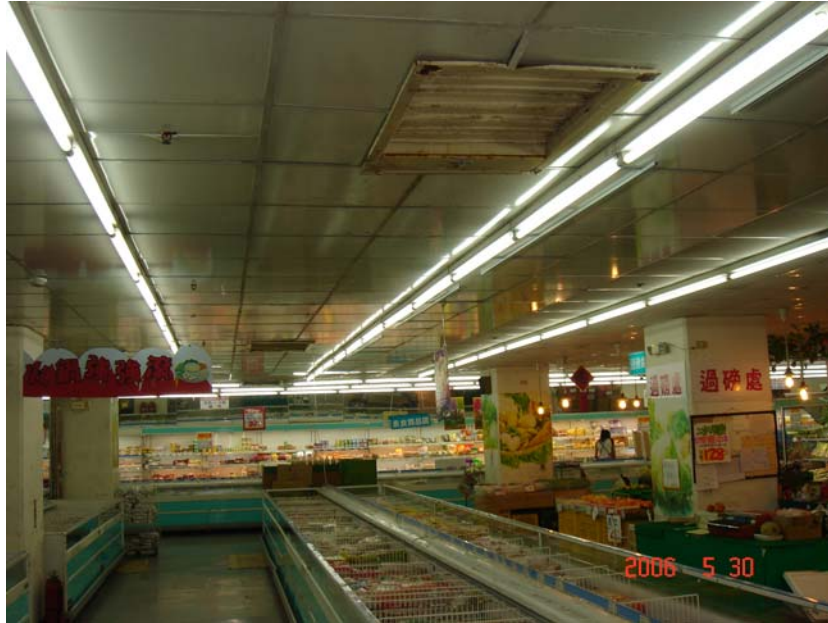
圖 3.2-7 生鮮蔬果區上方排煙閘門鏽蝕嚴重
