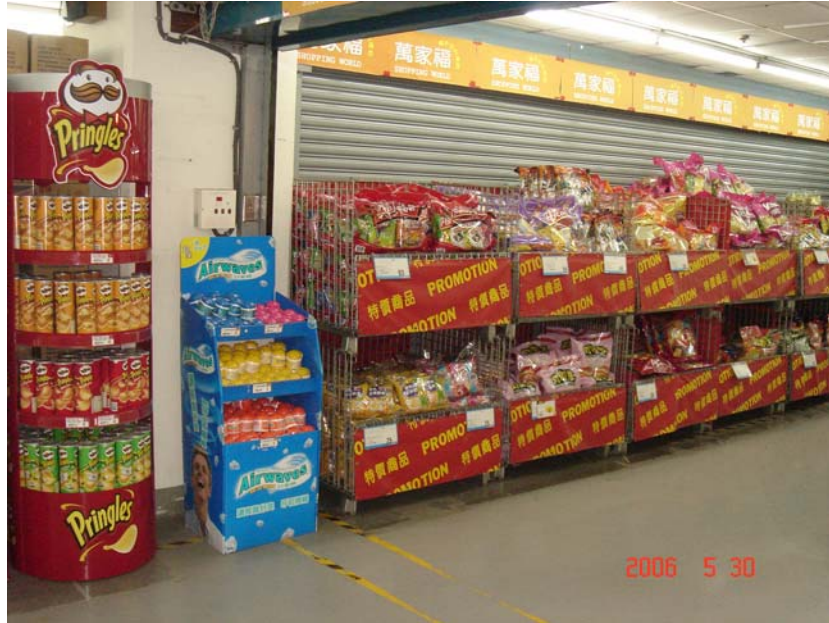
圖 3.2-12 防火鐵捲門下方堆放雜物破壞區劃
