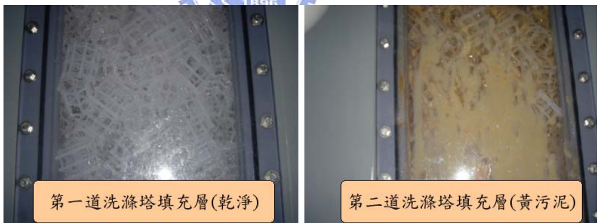
圖 30. 第一、二道洗滌塔填充材表面污泥累積狀況
