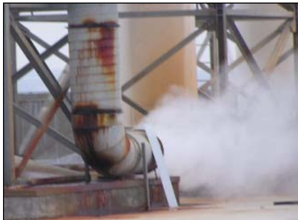
圖 5. 酸性排氣白煙對鍍鋅風管之腐蝕狀況(40 天)
