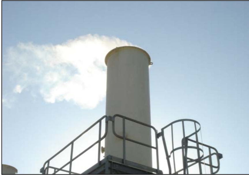
圖 4. 酸性排氣煙囪白煙(Scrubber 的負載為 25%)
