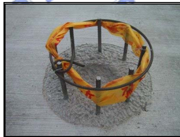
圖 3-16 防動塊與路盤混凝土界面
