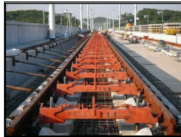
圖 3-128 鋼軌支撐架與側撐桿
