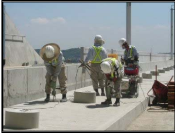
圖 3-31 臨時軌道墊片鑽孔
