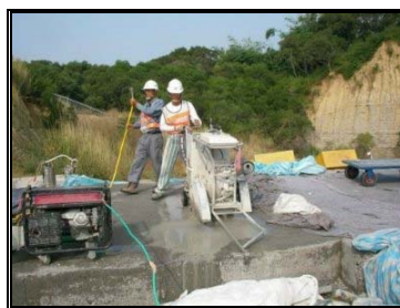
圖 3-93 裂縫引導縫切割
