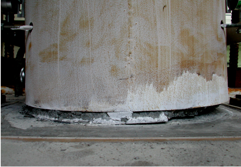
照片 3.1 第 1 次試驗後節塊底部受損情形
