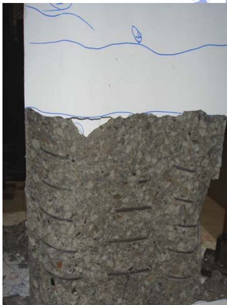
(a) 柱底塑鉸區混凝土剝落情形
