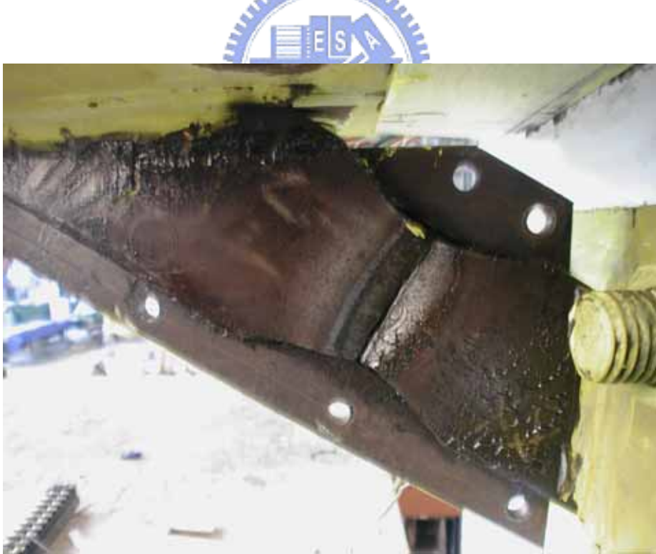
照片 3.8 試體 1 消能鋼板最窄削切處斷裂破壞( \theta = 0.03 rad)
