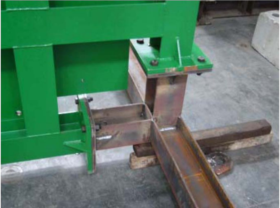
圖4-11 柱接頭特寫照片
