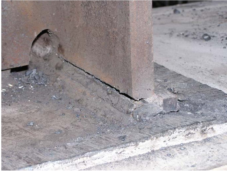
照片 5.14 試體二 BS600 梁下翼板於銲道處發生撕裂破壞(箱型協力桿件移除) (5% drift)
