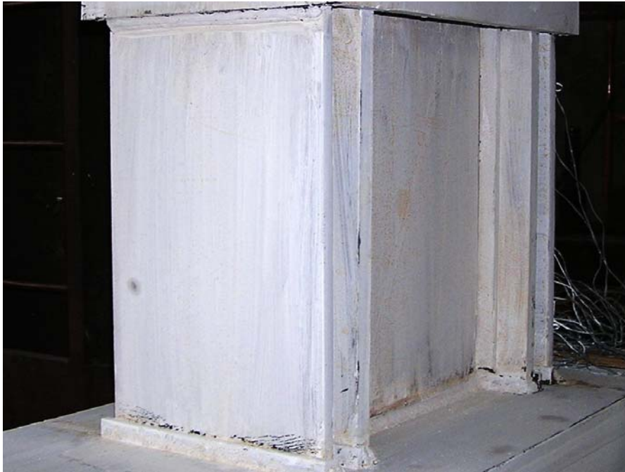
照片 5.2 試體一 CM600 於梁下翼板全滲透鐸道處石灰呈現放射狀剝落(0.375% drift)
