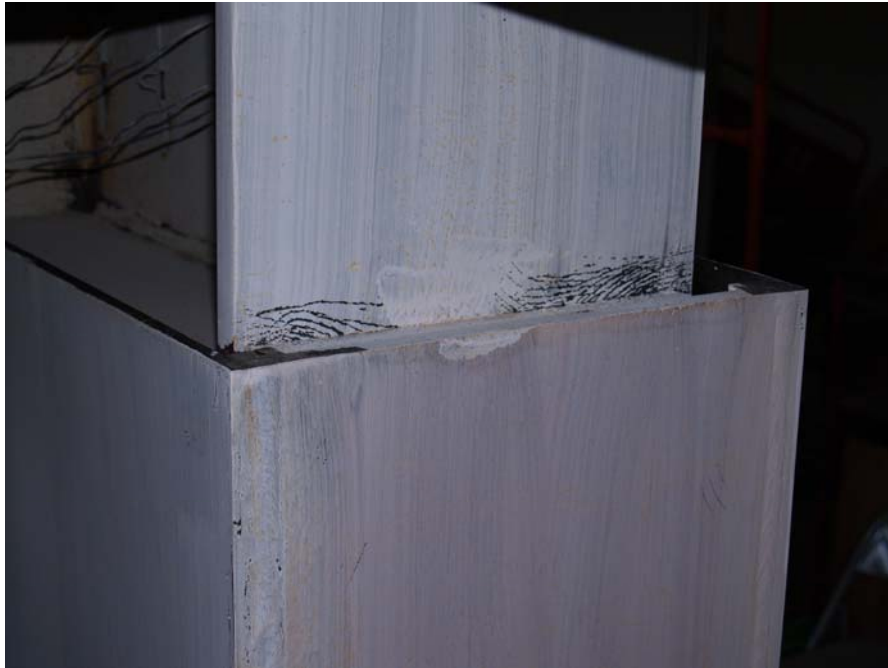
照片 5.10 試體二 BS600 支撐處斜向斑紋石灰剝落逐漸增加(1%)
