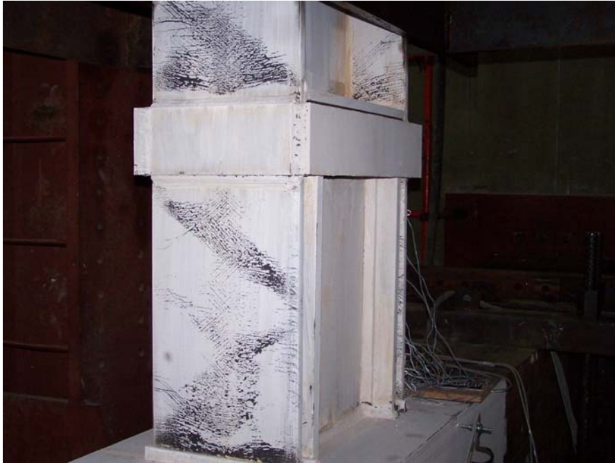
照片 5.4 試體一 CM600 大範圍之石灰斜向剝落出現於支撐段內之梁翼板及支撐段外側之梁翼板(2% drift)
