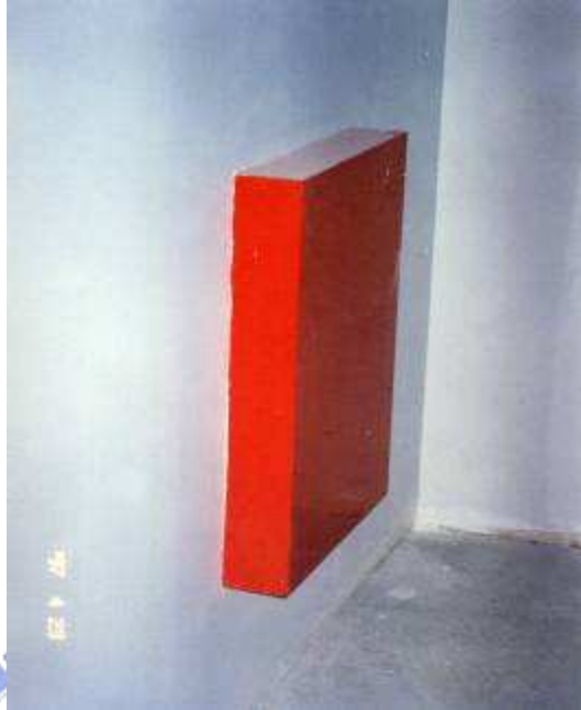
照片一 牆面厚度小於消防箱體厚度
