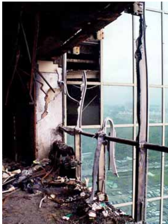
圖 18 東科大樓二樓帷幕牆因高溫使鋁框變形
