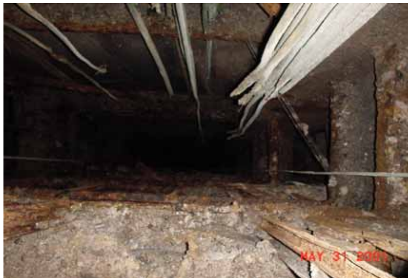
圖 20 東科大樓管道間鋼索因高溫及重力被拉斷，且未設防火閘門致大火高溫延燒到 18、19 等樓層
