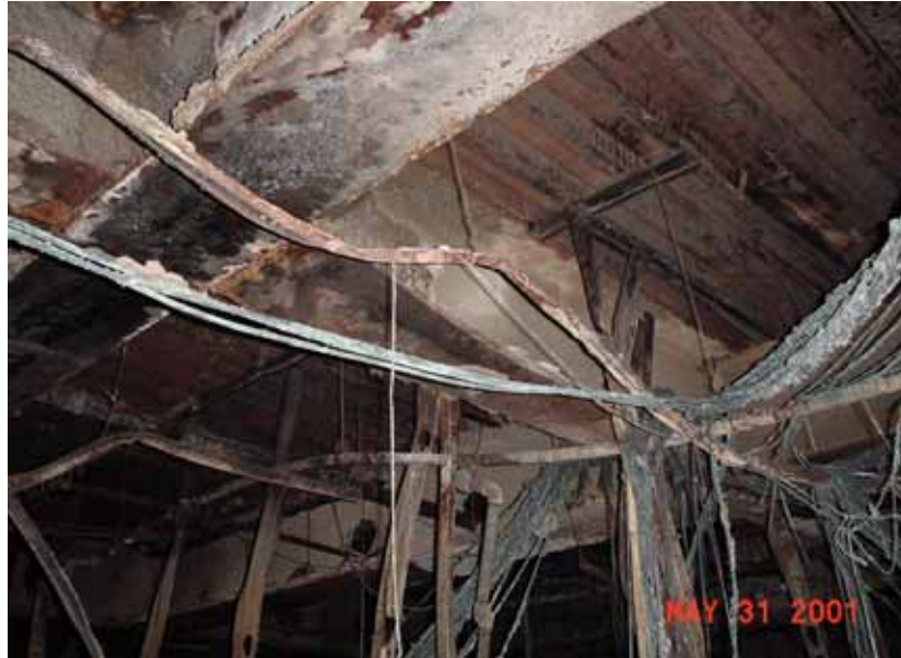
圖 19 東科大樓二樓電腦公司之電線電纜等配置狀況及燃燒後剩餘裸線部分
