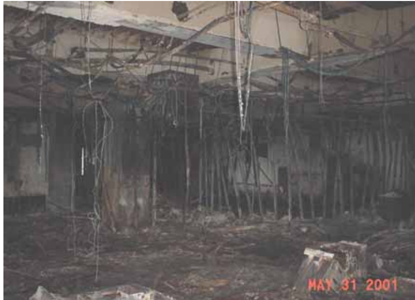
圖 21 東科大樓二樓石膏板隔間牆因高溫及救災之水損致防火區劃破壞現場
