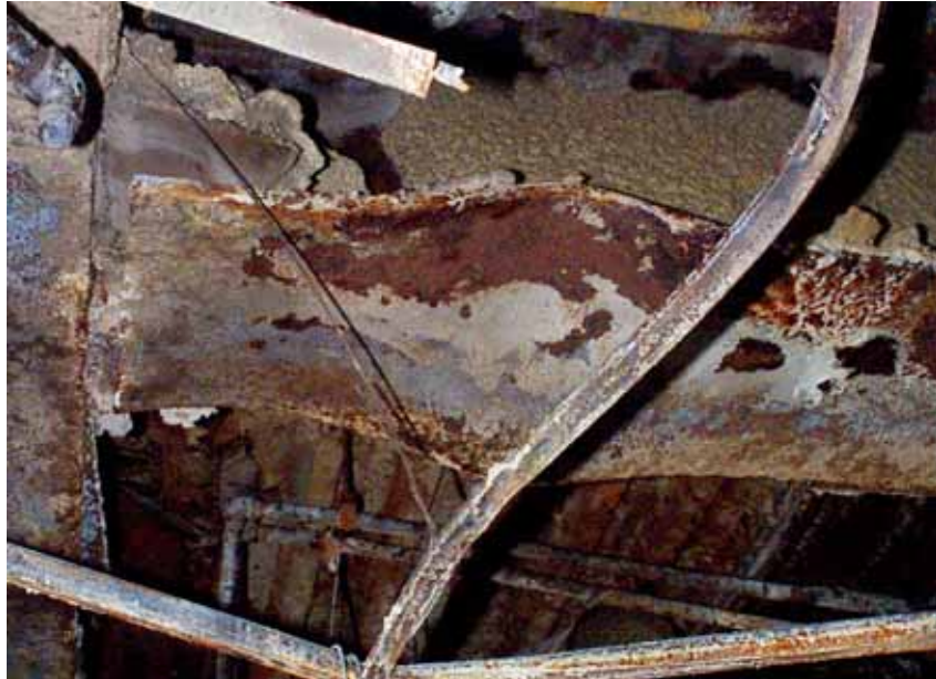
圖 17 東科大樓二樓H型鋼因高溫致扭曲變形
