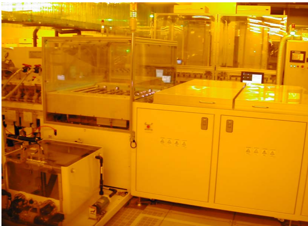
圖22 ITO-line之UV清洗機未使用幕簾
