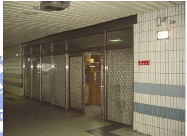
U-1層臺鐵非公共區防火區劃未設置
