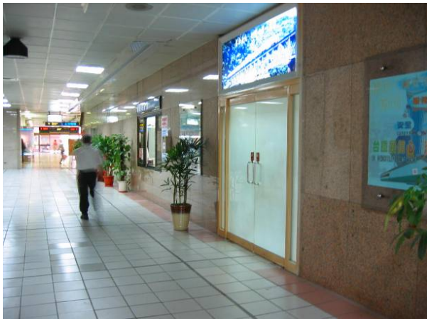
G+1層臺鐵非公共區防火區劃未設置
