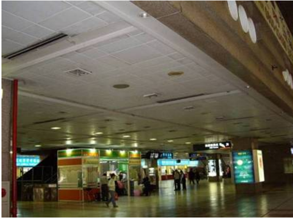
G+1車站公共空間未設置撒水頭防護
