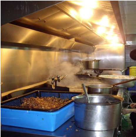
U-1餐旅廚房未設瓦斯漏氣火警設備
