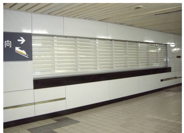
U-1層高鐵非公共區防火區劃未設置
