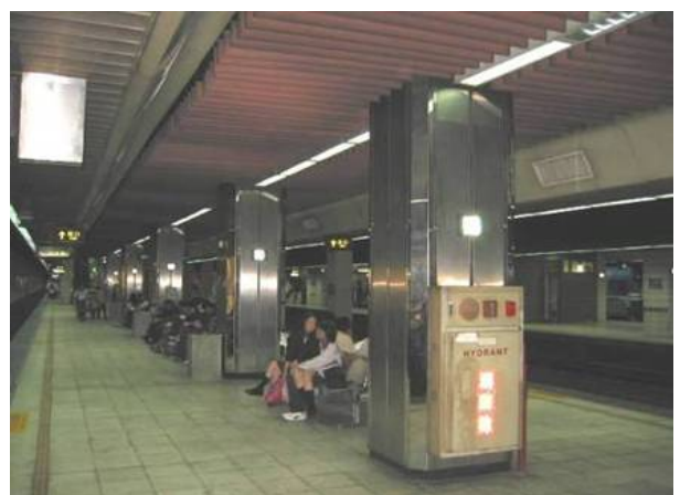
U-2月台層未設置防煙區劃
