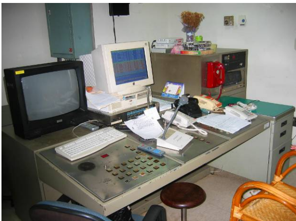
U2A 播音室未設置緊急廣播主機
