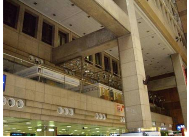
挑高空間分間牆未設置垂直防火區劃
