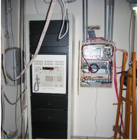
U2B新設火警系統未與監控副機連線
