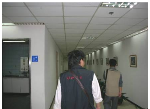
G+3層辦公區域未設置火警探測器
