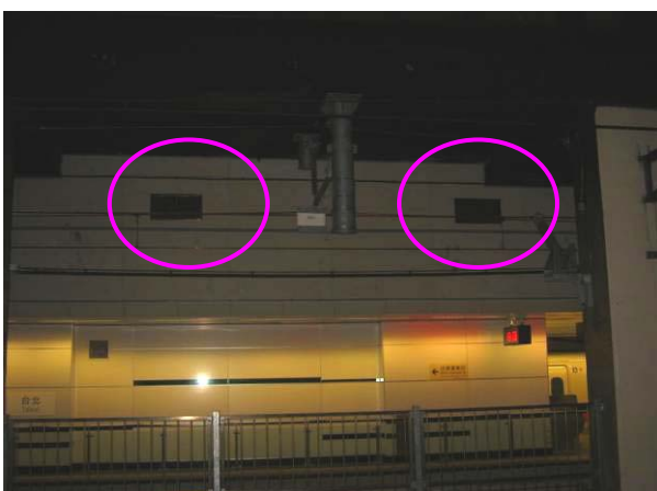
U-2 排煙口未設於月台天花板下方
