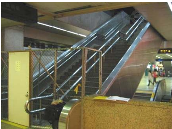
G+2層樓梯總寬度不足未設特別安全梯
