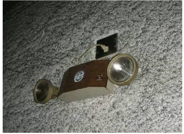
緊急照明燈分布數量不足照明不均
