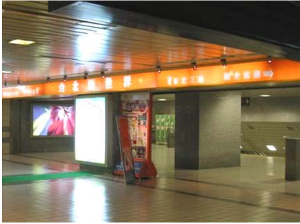
地下街接口防火區劃捲門未設防火門
