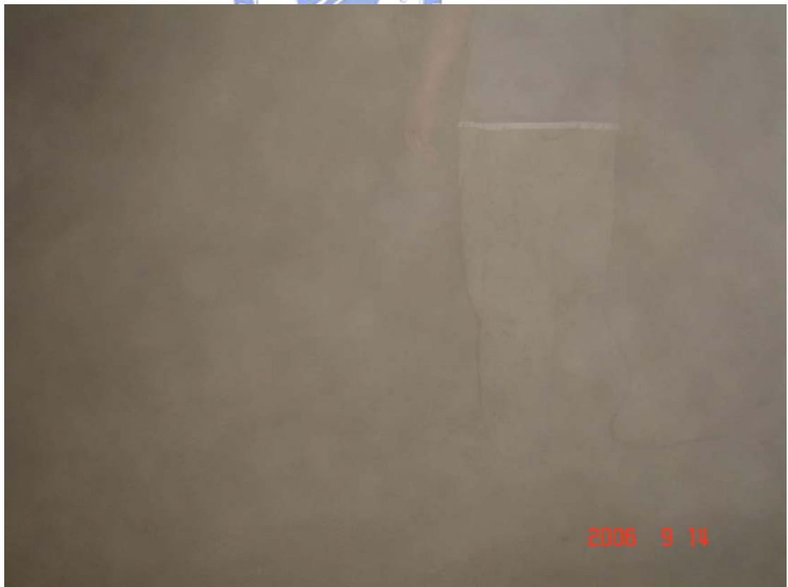
圖 3-5 研磨作業中瞬間會揚起大量粉塵微粒(地下室)
