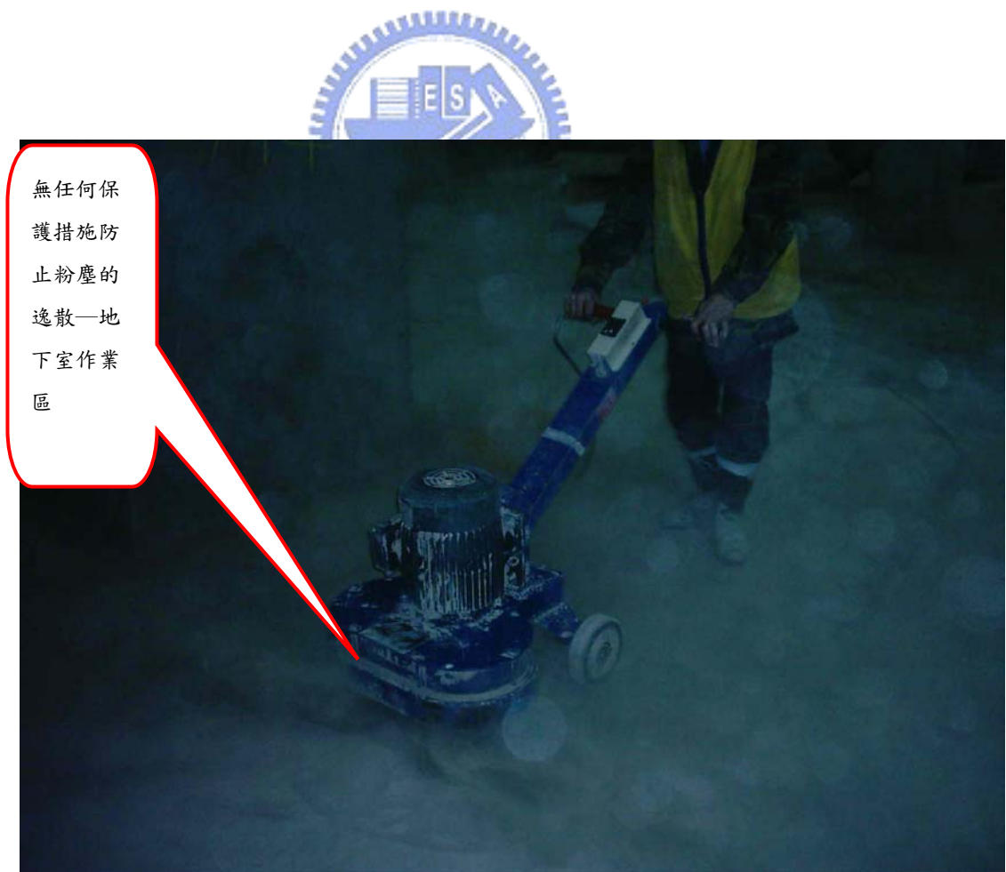
圖 1-1 研磨作業時粉塵逸散情形(地下室作業區)—無防護措施
