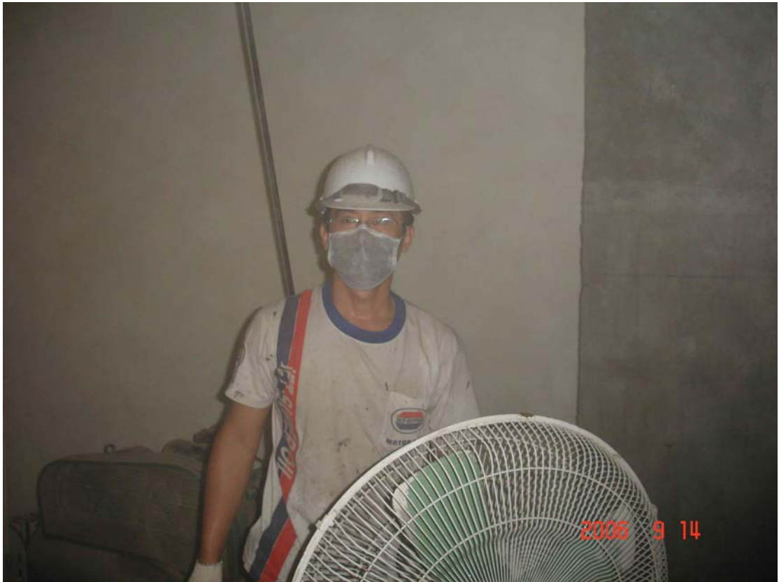
圖 3-10 研磨作業時粉塵逸散情形(地下室)—作業勞工防護措施
