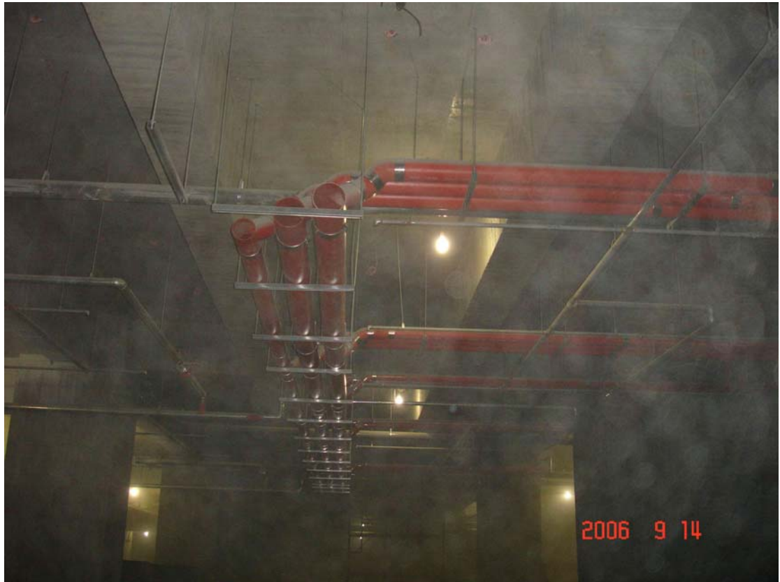
圖 3-8 研磨作業粉塵逸散污染設備管線(地下室)-消散中
