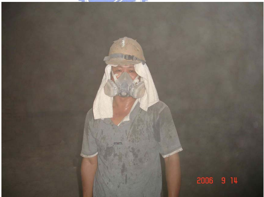
圖 3-9 研磨作業時粉塵逸散情形(地下室)—作業勞工防護措施
