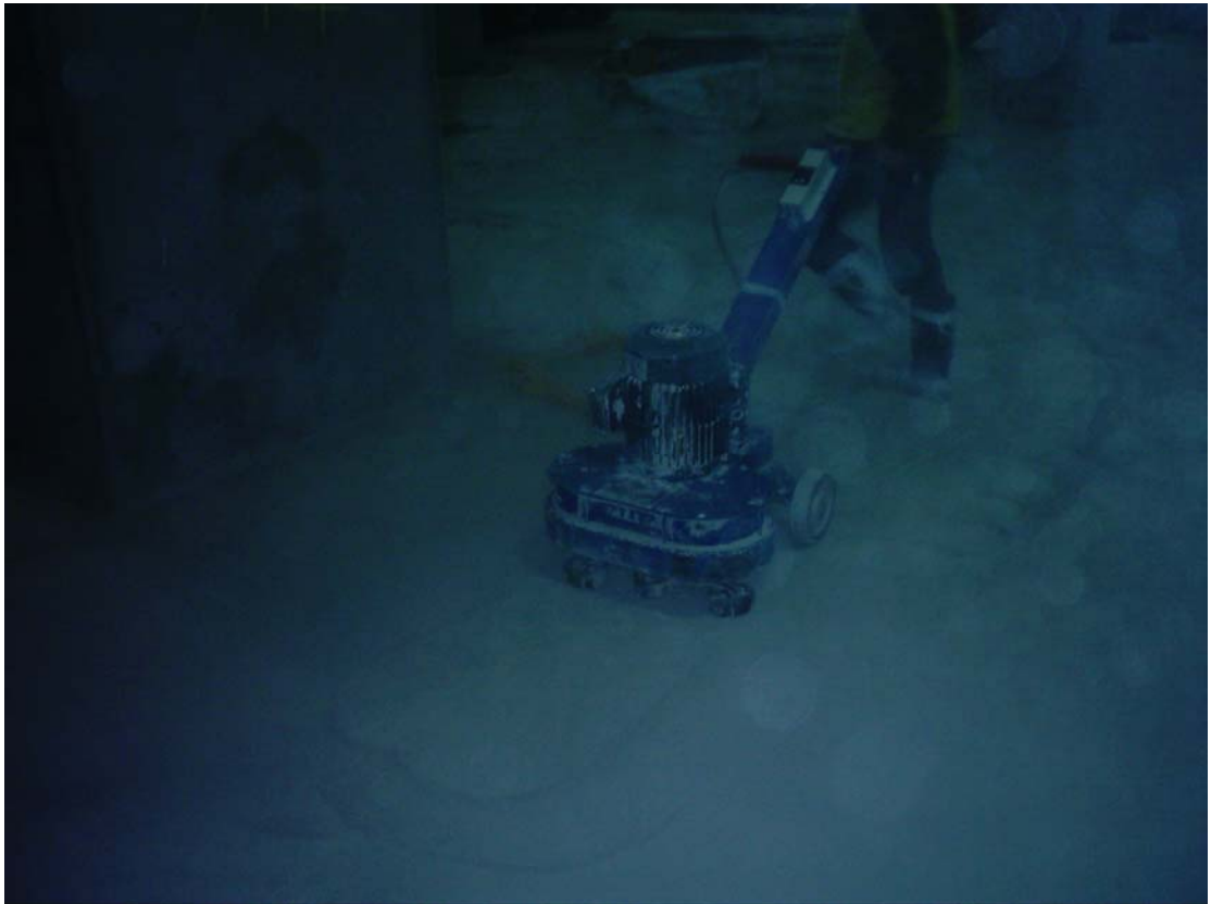
圖 3-4 研磨作業瞬間會揚起大量粉塵微粒(地下室)
