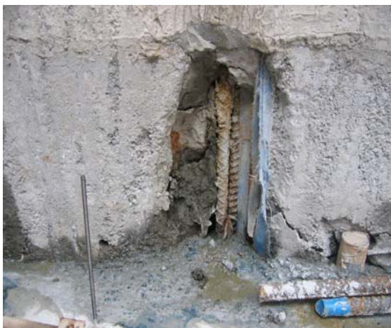
照片 5-8 壁面包泥造成滲水
