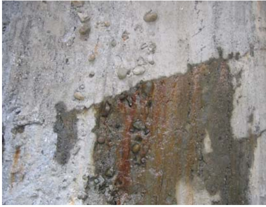
照片 5-10 壁面裂縫滲水
