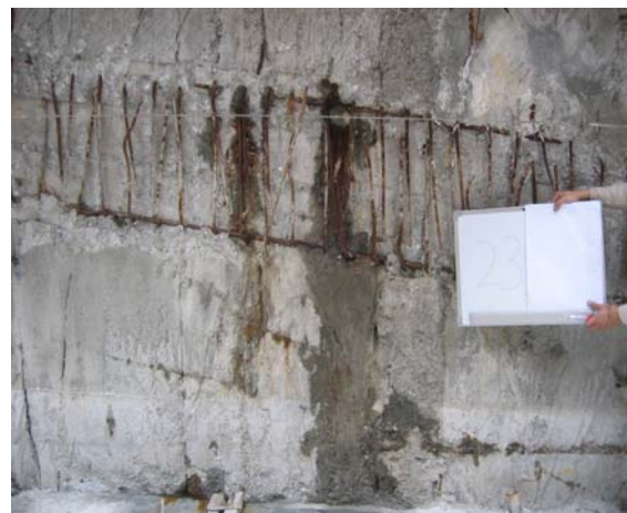
照片 5-9 預留鋼筋周圍滲水
