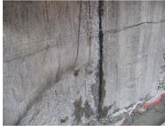
照片 5-11 公母單元交界面滲水
