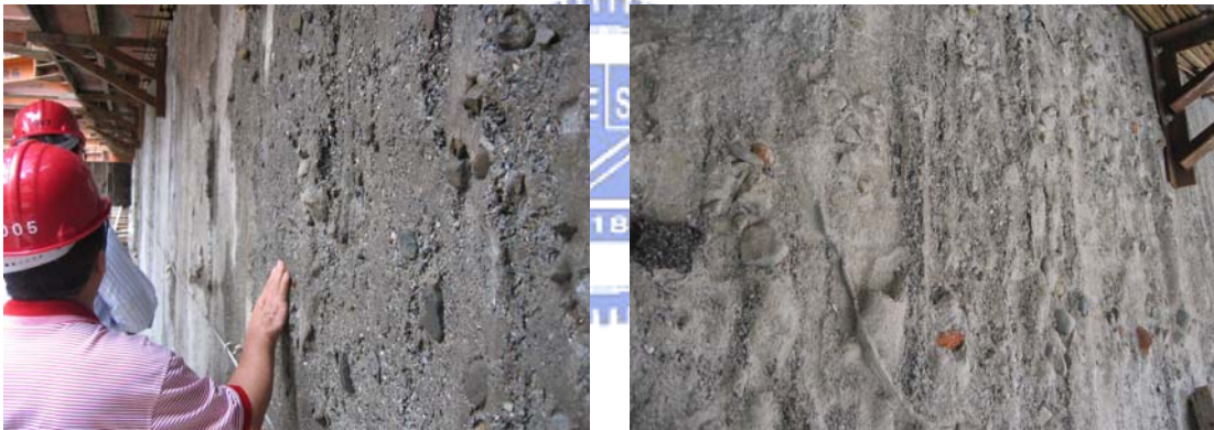
照片 5-1 案例工程局部呈現參雜石粒、泥漿流失現象
