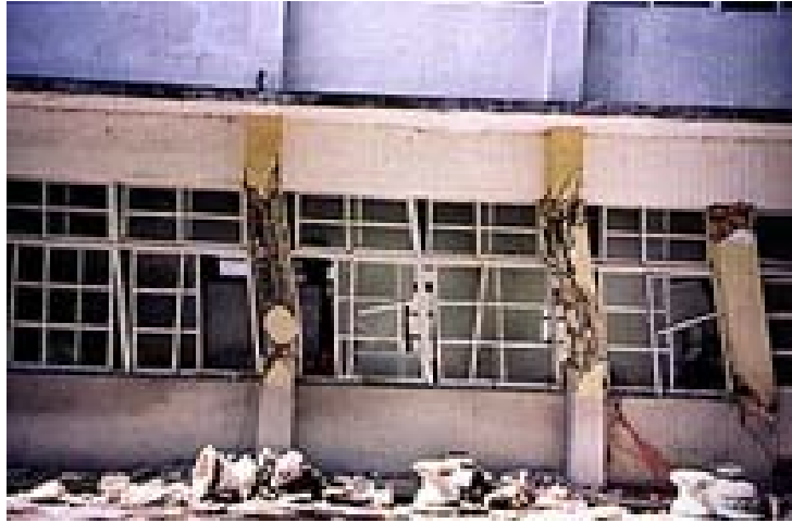
圖 3.1(a) 短柱效應造成短柱的剪力破壞 (圖片來源：國家地震中心)
