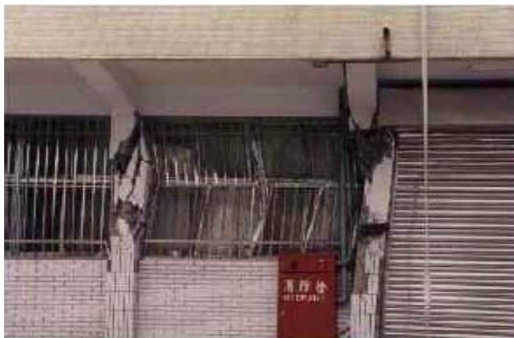
圖 3.1(c) 短柱效應造成短柱的剪力破壞 (圖片來源：國家地震中心)
