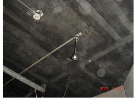
圖 3.2.16 細水霧懸吊系統
