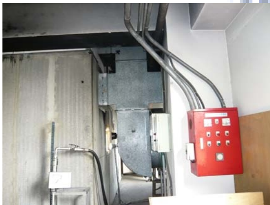
圖 3.2.13 撒水變頻控制盤系統
