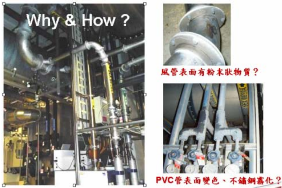
圖 3-1:CVD 製程管路區環境異常
