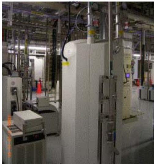
圖 3-4:局部廢氣處理設備
