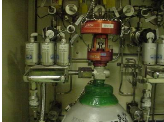
圖 63 氣瓶櫃緊急遮斷閥照片
