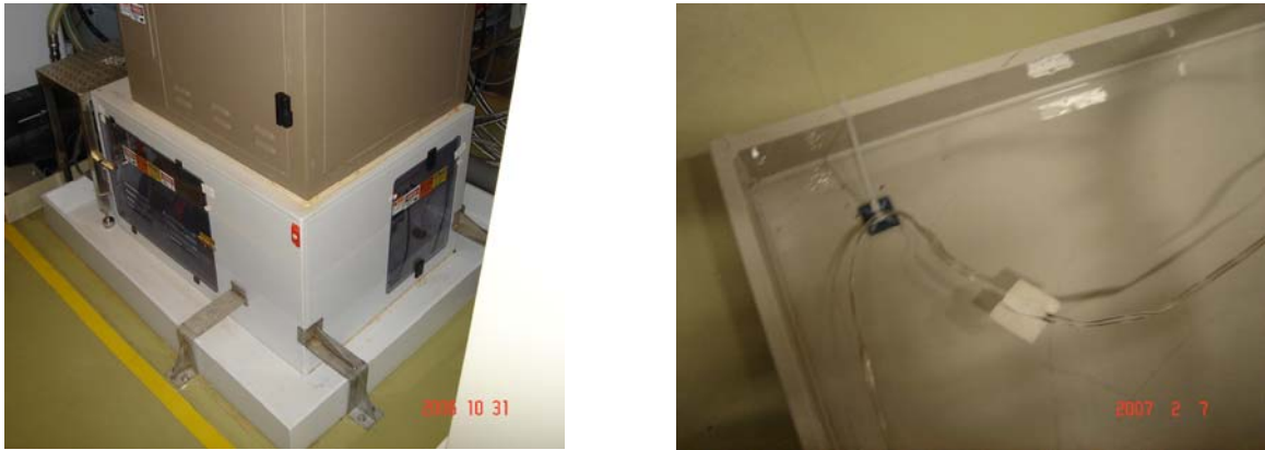
圖 56 防止化學品洩漏盛液盤及洩漏探測器照片
