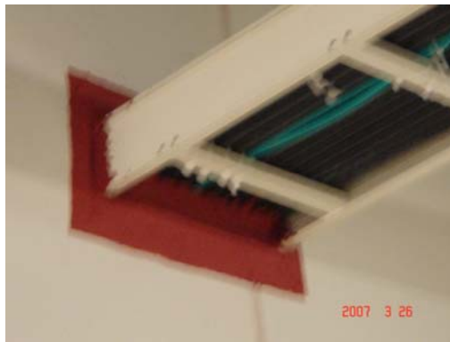
圖 68 防火區劃防火填塞照片
