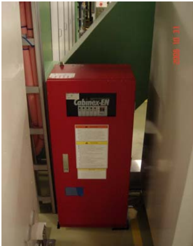
圖 66 獨立機台的內部滅火設備
