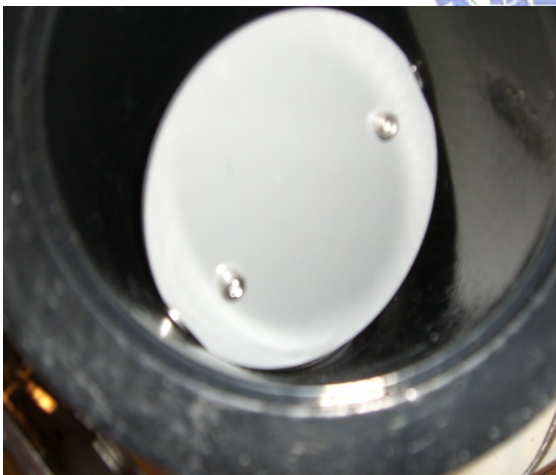
圖 4-6 Scrubber 本身之 Damper
