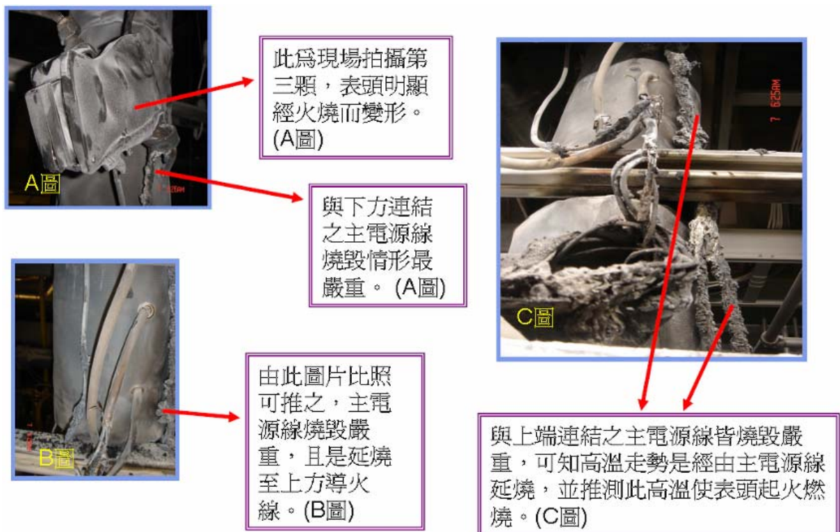
圖 4-16 加熱帶燒毀之異常事故照片
