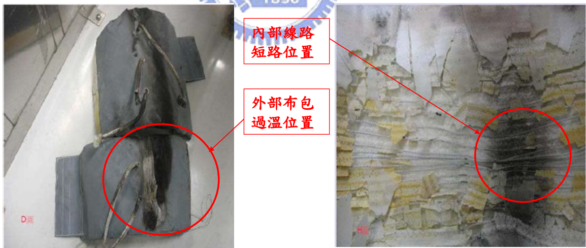
圖 4-18 溫控器內 SSR 遭電流過大而擊穿電線且過熱照片
