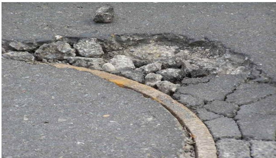
圖 2-22 人(手)孔周圍加固瀝青混凝土壓損(不能辨識管理單位)
