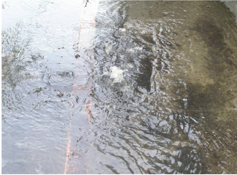
圖 2-23 積水造成路面浸蝕（一）
