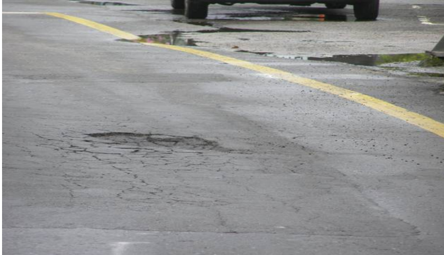
圖 2-17 自然坑洞損壞
