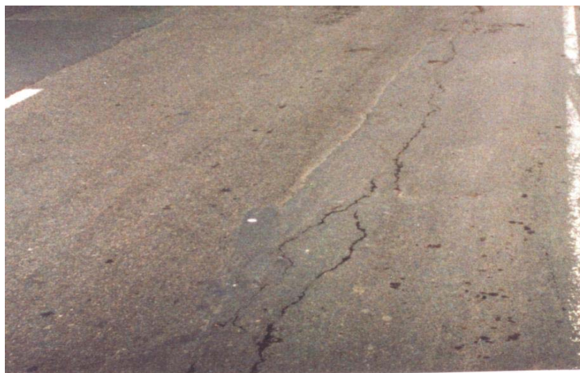
圖 2-2 路面縱向裂縫
