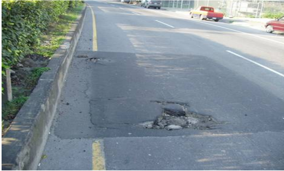
圖 2-20 施工回填不實 (二)
