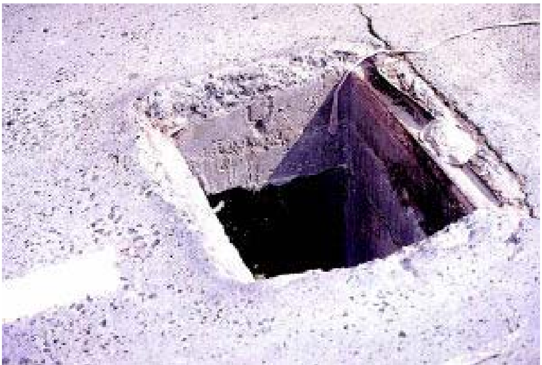
圖 1-2 下水道孔蓋遺失誤解為坑洞
