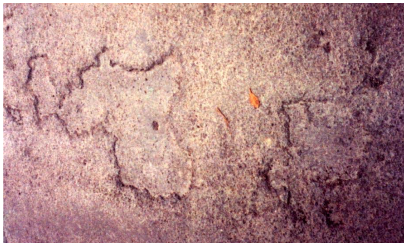
圖 2-12 路面薄層剝離
