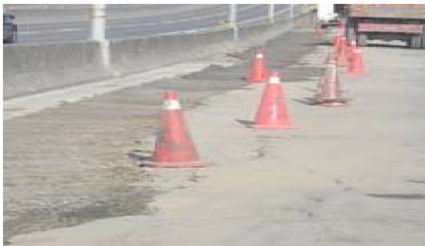
圖 2-19 施工回填不實（一）
