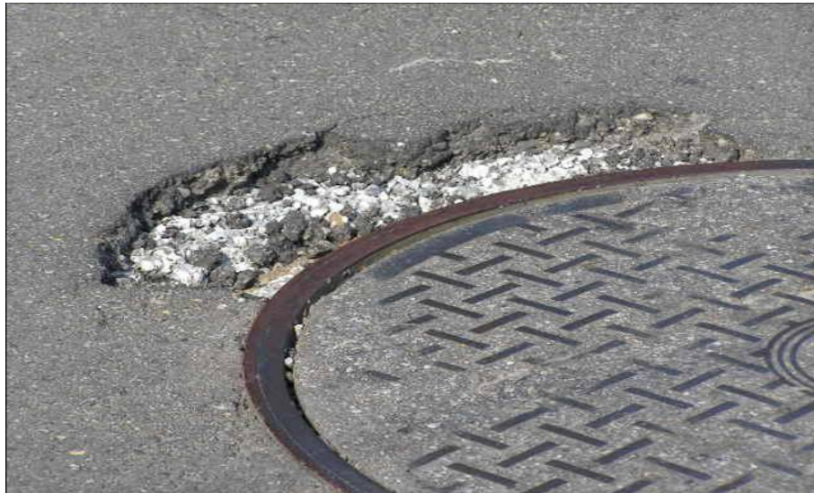
圖 2-21 人(手)孔周圍加固瀝青混凝土壓損(可明顯辨識管理單位)
