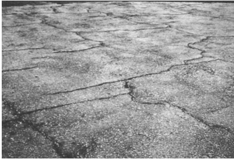
圖 2-4 路面塊狀裂縫
