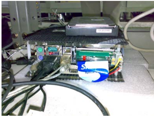
(a)實機裝設於雪山隧道機房中
