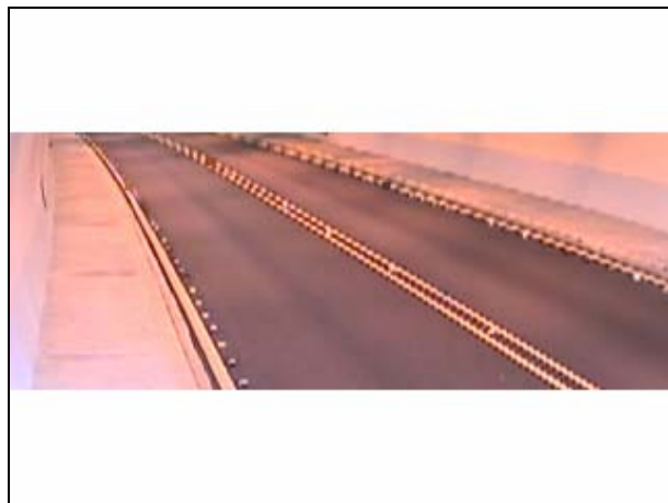
圖 5.4.1-2 雪山隧道編號第 2076 支 CCTV 攝影機收斂的背景影像
