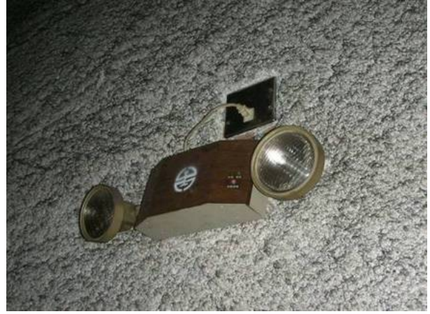
緊急照明燈分布數量不足照明不均
