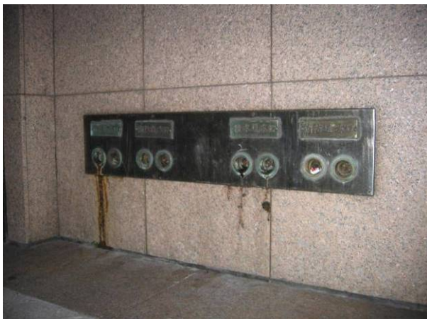
送水口老化鏽蝕滲漏破損，缺採水設備
