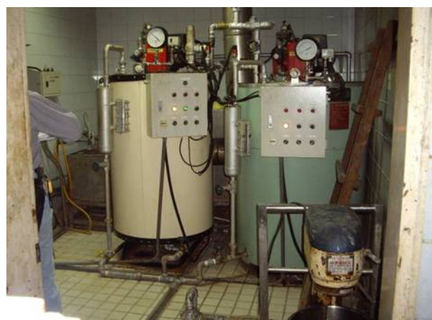
G+6鍋爐室未設置防火門及CO監測設備
