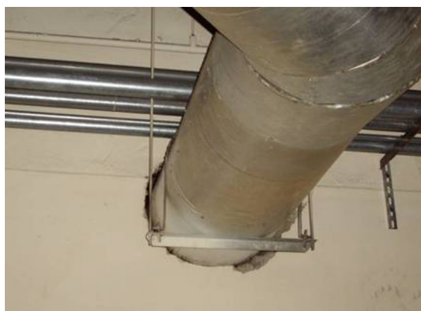
風管管道貫穿防火區劃處未作防火措施
