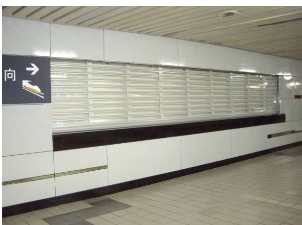
B1層高鐵非公共區防火區劃未設置
