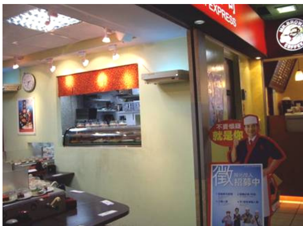
G+1餐廳廚房未設防火區劃
