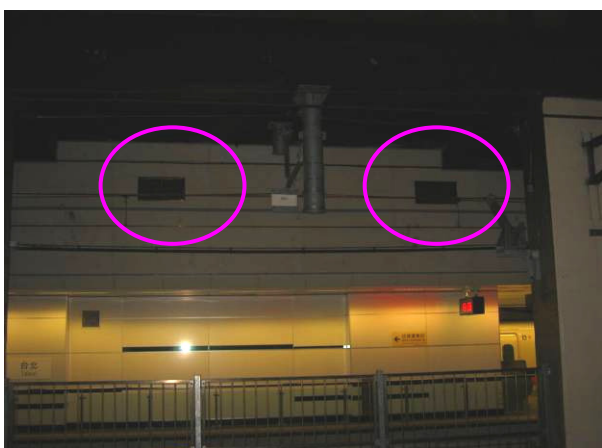
B2 排煙口未設於月臺天花板下方
