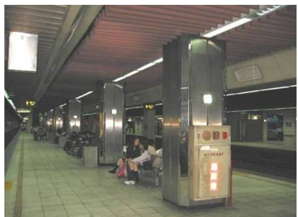
B2月臺層未設置防煙區劃
