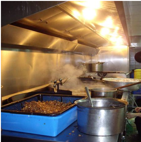
B1餐旅廚房未設瓦斯漏氣火警設備
