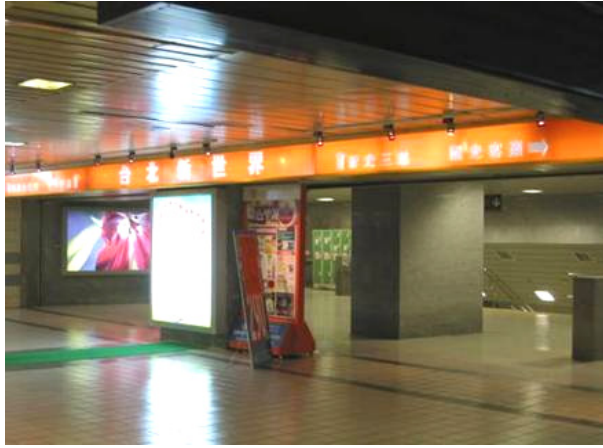
地下街連接口防火區劃捲門未設防火門
