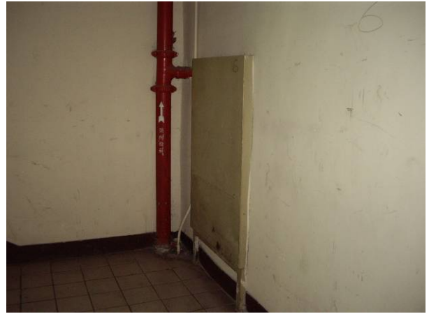
室內消防栓箱破壞安全梯間防火區劃
