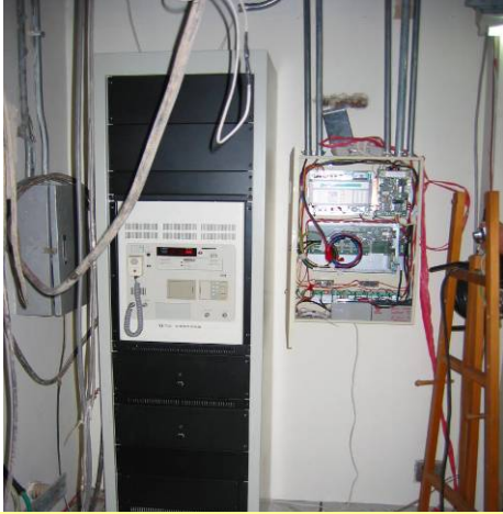
B2B新設火警系統未與監控副機連線
