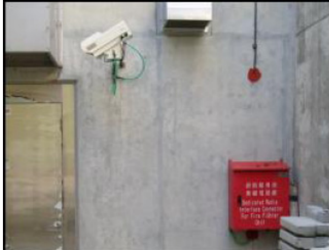
圖5.3 無線電通信輔助設備－無線電接頭
