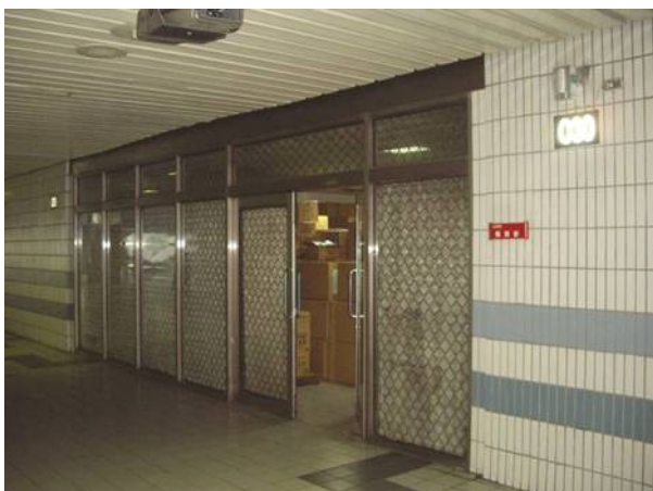
B1層臺鐵非公共區防火區劃未設置
