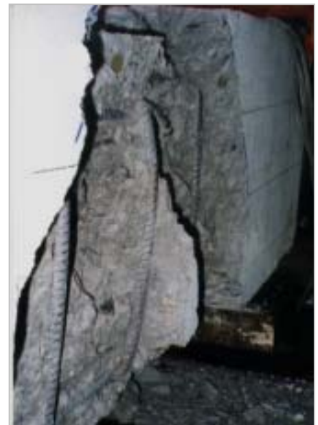
(b) 剝除壓碎混凝土後情形 ( 側面 )
