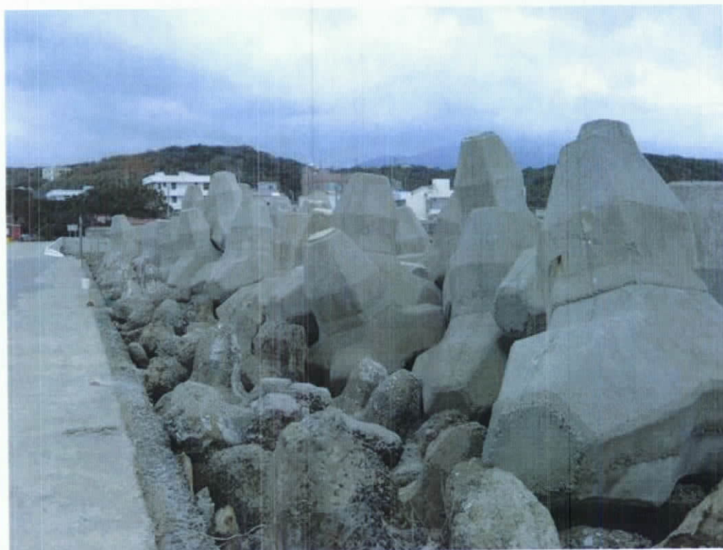
照片 5-13 【10】南防波堤消波塊—側面
