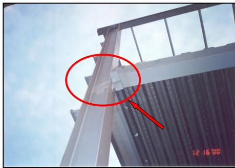
圖 十一 梁柱接頭區之橫隔板問題
