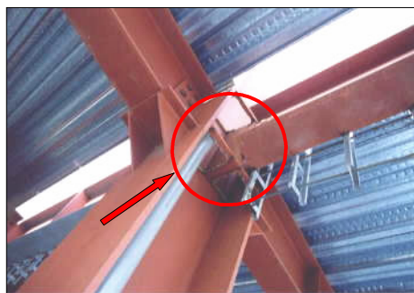
圖四 梁柱接頭處之配管與開孔問題
