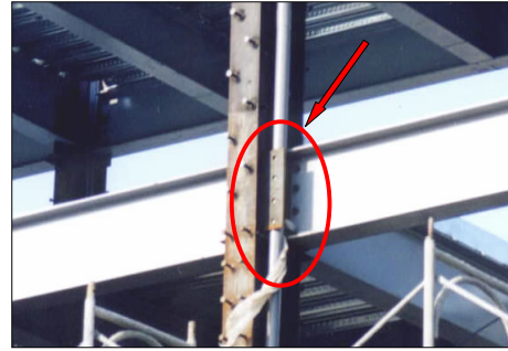
圖五 管線配置不當以致影響接頭正常接合
