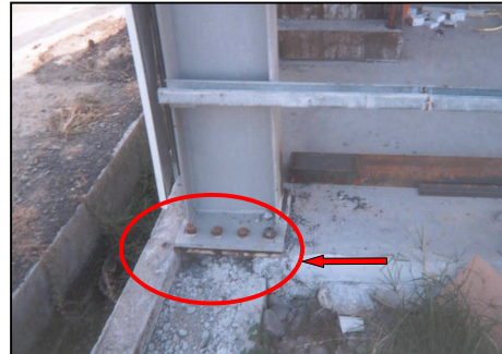
圖 十四 柱基板下方之混凝土施工問題
