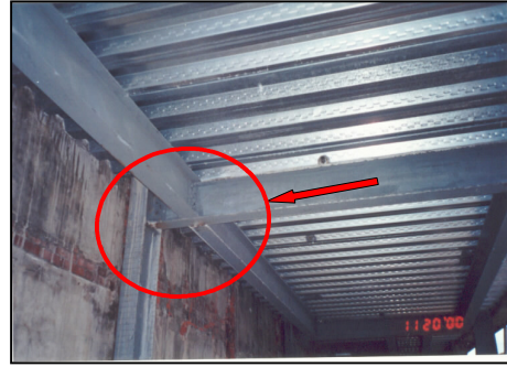
圖 十三 鋼柱與鋼梁明顯配置不當且不符合強柱弱梁之原則
