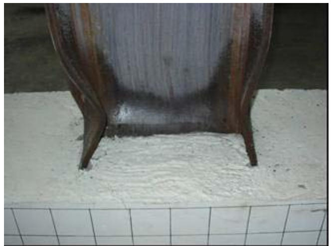
照片八 試體 SRC5 之鋼梁塑性變形情形
