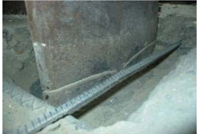
照片七 試體 SRC4 之鋼梁翼板拉裂情形
