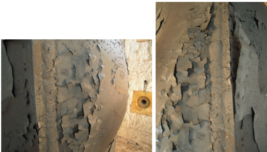
圖 4-24 試體 B4R-.2 耐火試驗後柱板表面剝離情況
