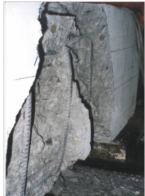
(c) 剝除壓碎混凝土後情形 (側面)
