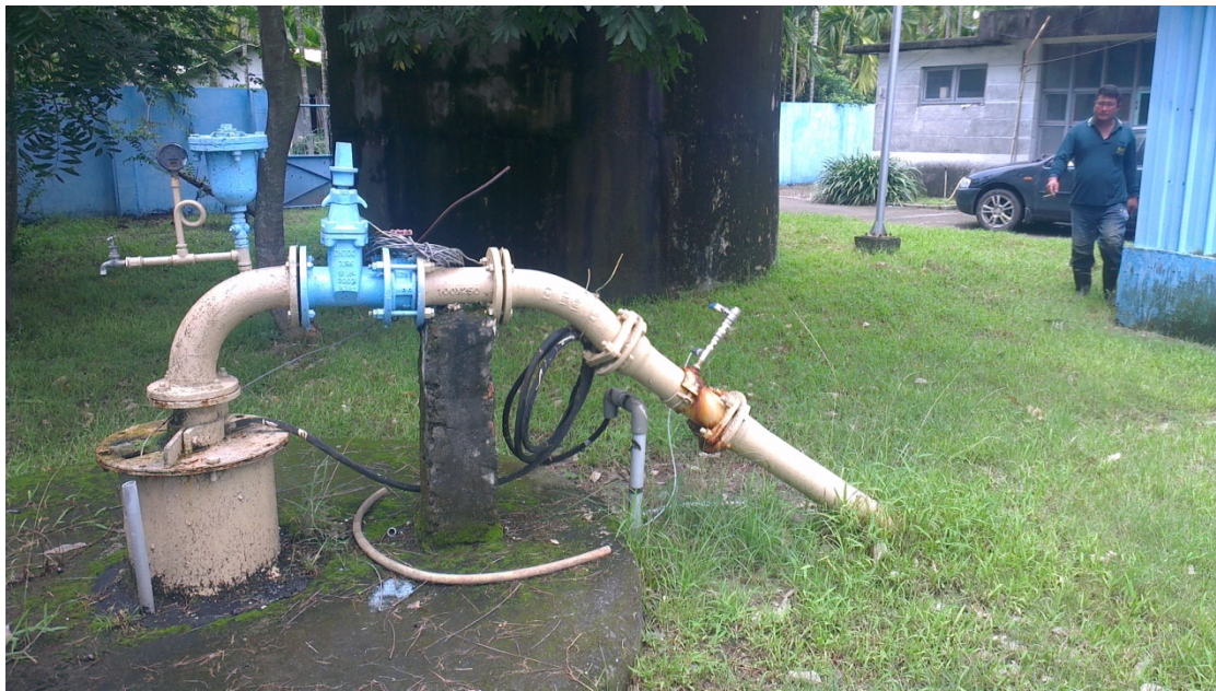
圖 5-7 自來水公司四春淨水場水井
