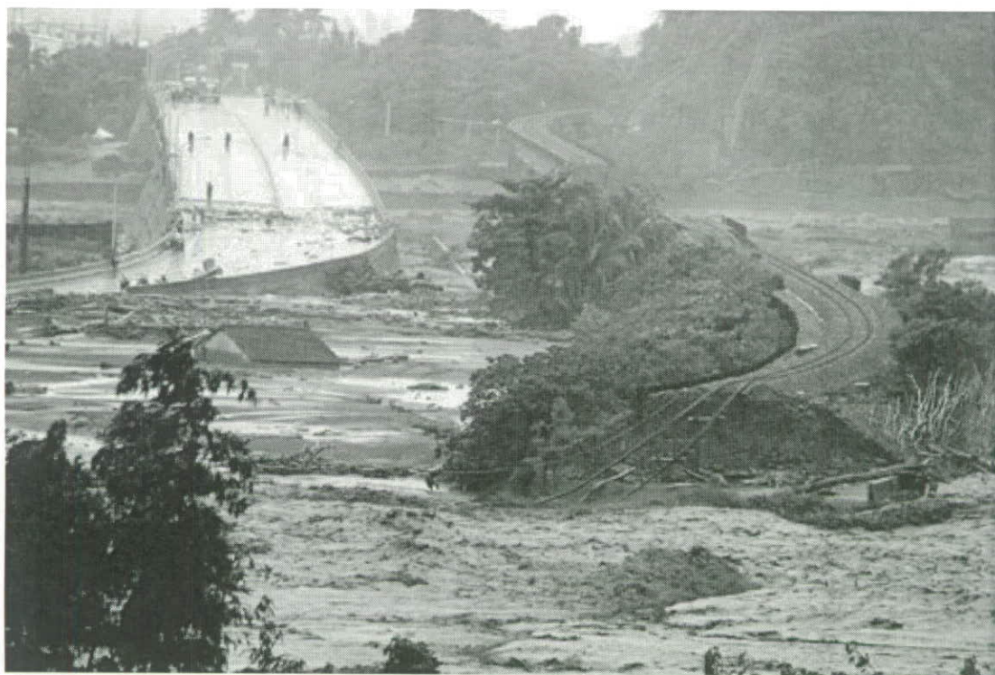
圖 4-6 南迴公路與南迴鐵路太麻里段於莫拉克颱風受損圖
