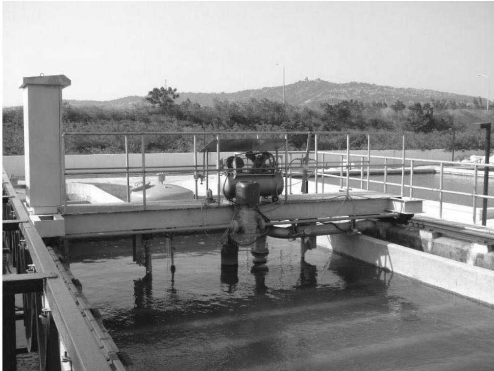
圖 4-30 太湖淨水場 ABW 式快濾池
