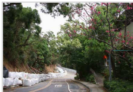
坍塌路段堆置太空包，以阻擋崩落的土石
