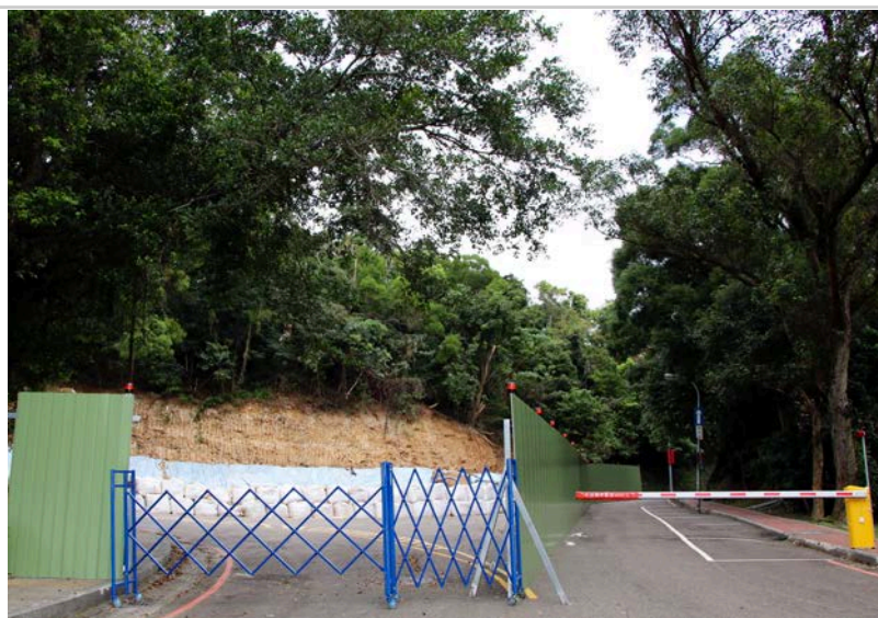
動物中心前方邊坡陷落，已完成初步搶修工程與管制設施設置
