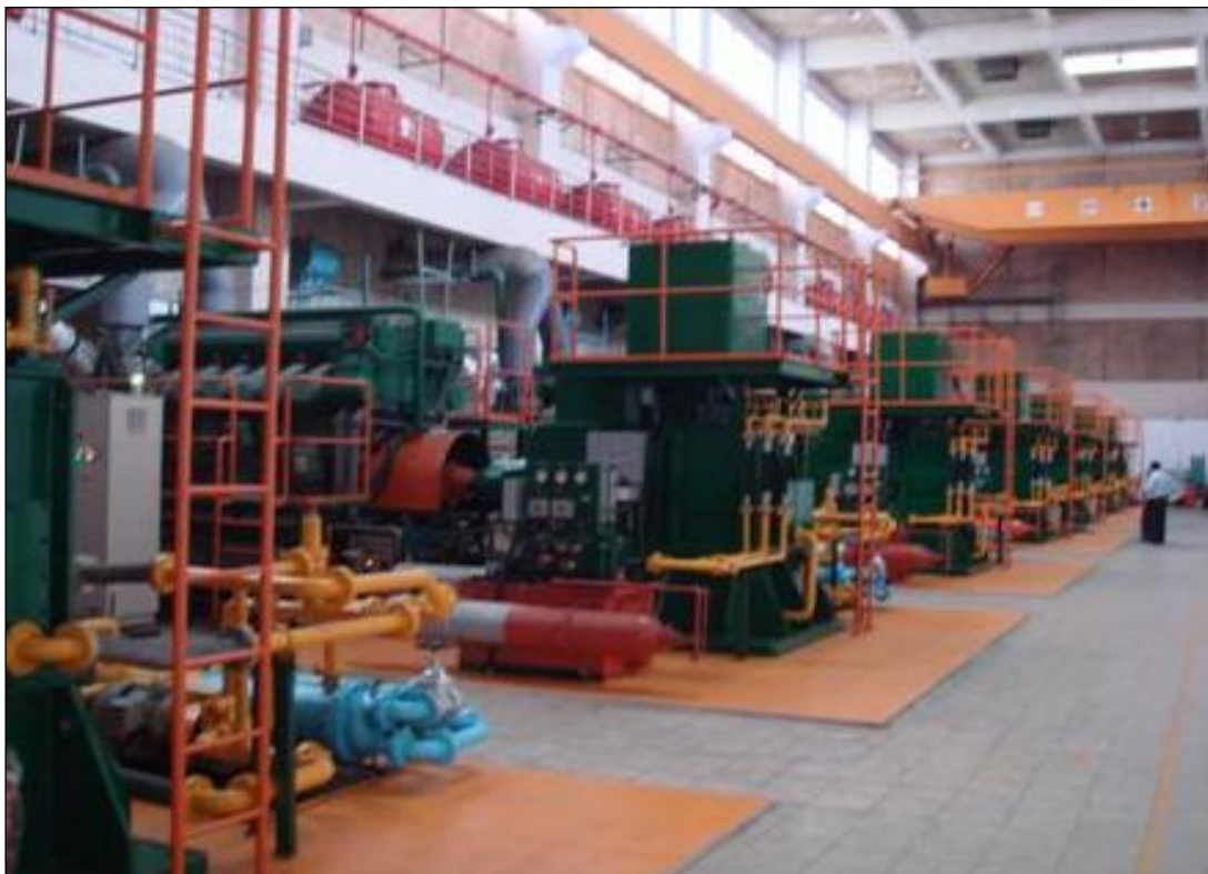
圖 8 抽水機組配置現況
